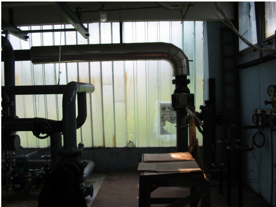
Régi hőközpont belső
