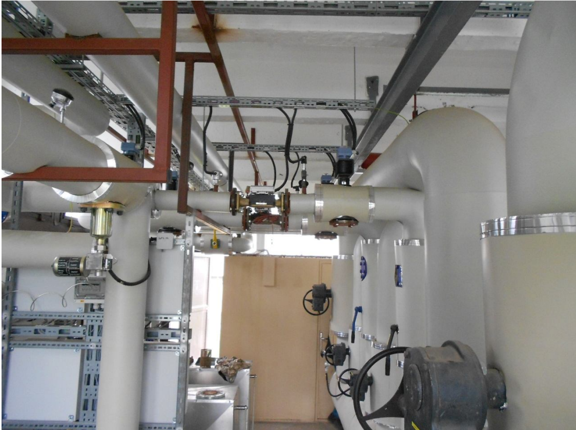
Vezetékek és főelzárók
