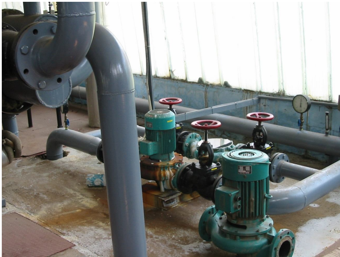
Régi cirkulációs szivattyúk
